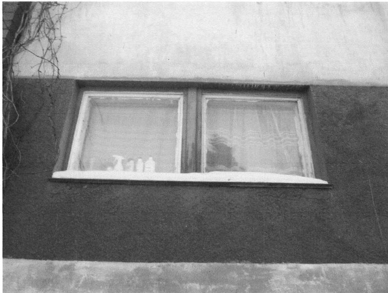
1.attēls. Ēkas koka rāmju logi ir sliktā tehniskā stāvoklī, ieteicama to nomaīņa.
