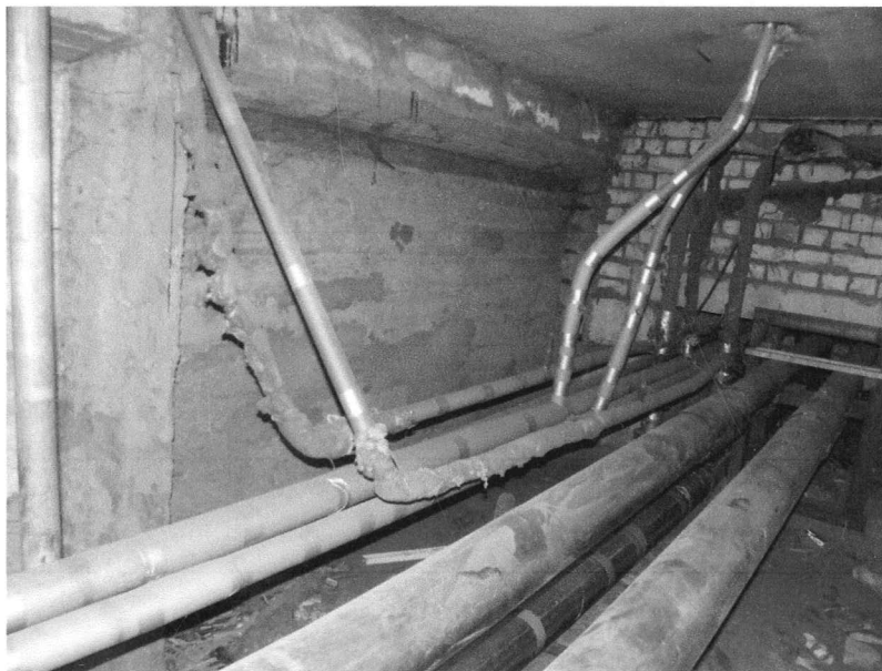
2.attēls. Daļa cauruļvadu un stāvvadu siltināti pagrabā.
