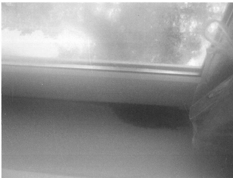
4.attēls. Ievietojot plastmasas tipa pakešu logus dzīvoklī nepietiekamas ventilācijas dēļ radusies pelējumsēne. Nepieciešams iztīrīt ventilācijas šahtas un regulāri ventilēt telpas.
